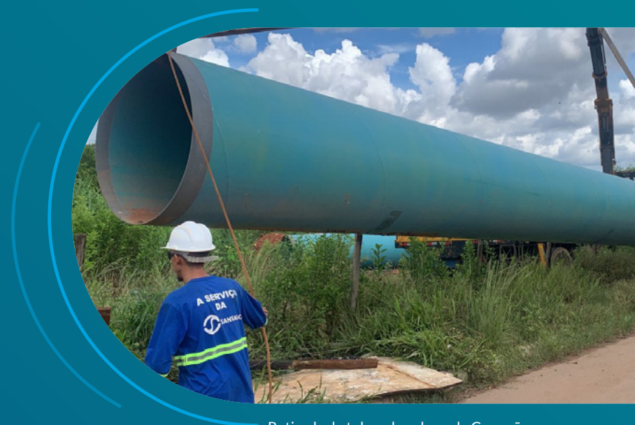
Retirada de tubos das obras da Conexão Cristina na Vila Roriz - Acervo Saneago.
