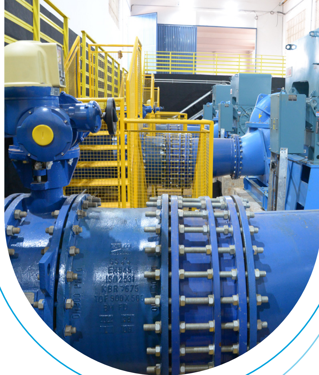
Estação elevatória Senac Acervo Saneago.
