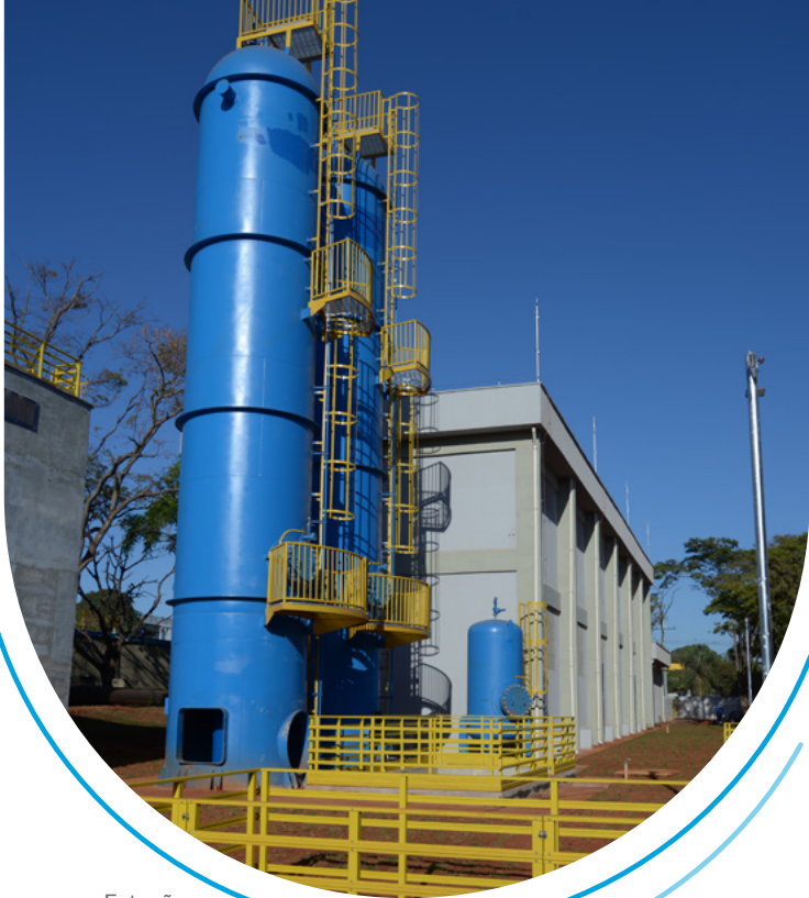
Estação elevatória Senac Acervo Saneago.
